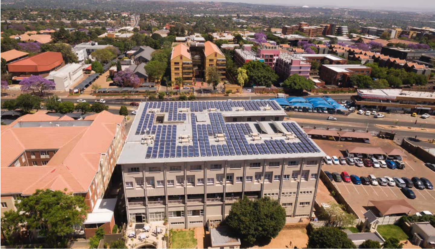
Installation photovoltaïque solaire sur le toit de l'hôtel Apollo à Johannesburg, en Afrique du Sud
